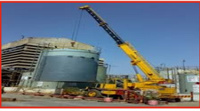
GFL Site Dahej
